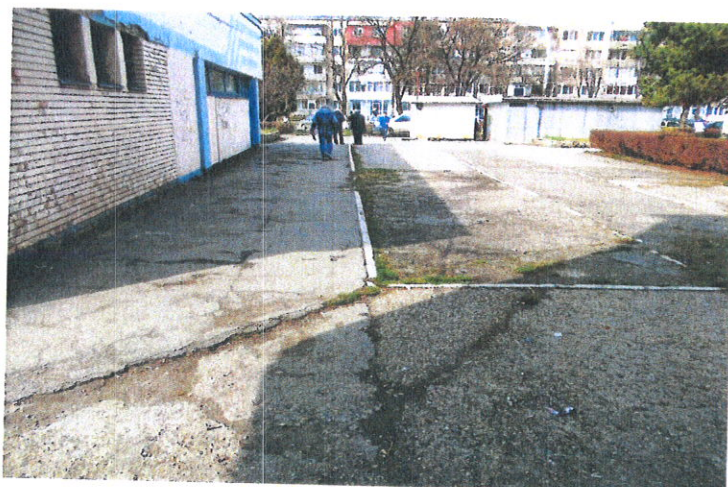
Foto 2. Îmbrăcămintă cu fisuri și crăpături majore
